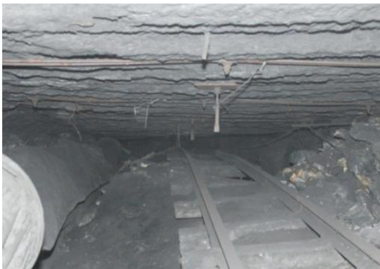
图 3-1 注浆加固前巷道破坏情况
